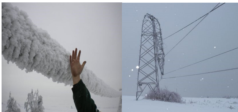
Rys. 1. Pokrycie szadzią i katastrofy linii energetycznych Fig. 1. Hoarfrost covers and damage of the overhead power lines
